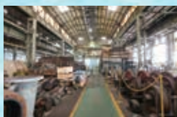
修繕工場 （北九州市）
